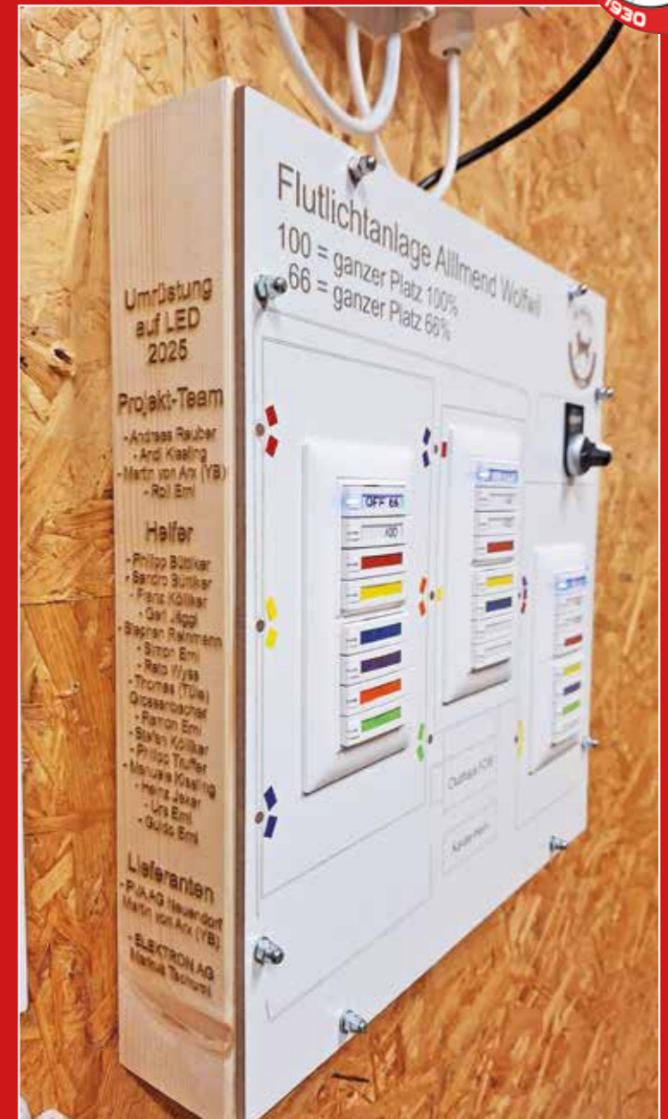
Erleuchtung in der Vereinskasse: Die LED-Strahler brauchen rund zwei Drittel weniger Strom als die alte Anlage aus dem Jahr 1970. Foto: zvg
